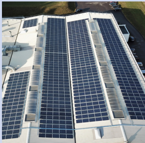
Bild: Helios Sonnenstrom GmbH
