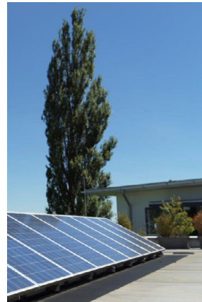
Bürogebäude der KNV Energietechnik, Schörfling am Attersee. Der Strombedarf für die Büroraumkühlung mittels Wärmepumpe kommt vor allem von der PV-Anlage.
