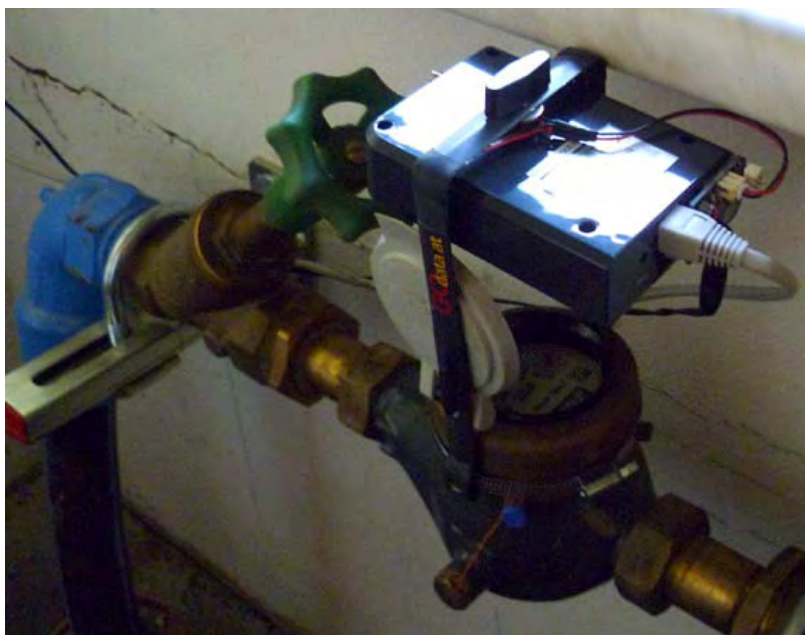
Abbildung 59: Ableseeinheit für den Wasserverbrauch
