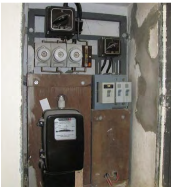
Abbildung 10: Nicht mehr heutigen Standards entsprechende Elektroinstallation
