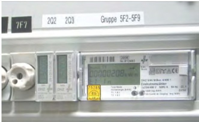
Abbildung 14 (oben): Links zwei 1-Phasen-Wechselstromzähler, rechts ein 3-Phasen-Drehstromzähler
