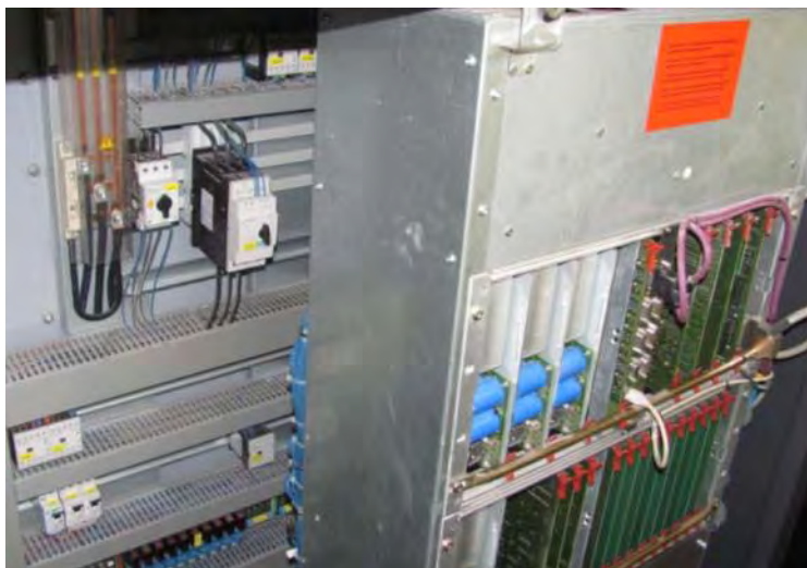
Abbildung 74: Submessungen an den Druckmaschinen erfordern den Einsatz von Wandlermessgeräten
