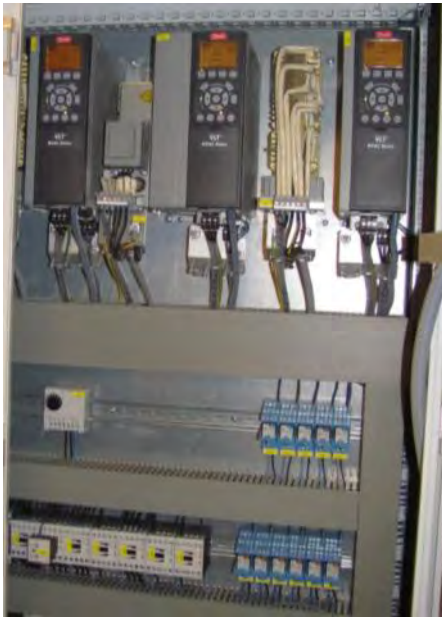
Abbildung 71: Steuerung der Kälteanlage
