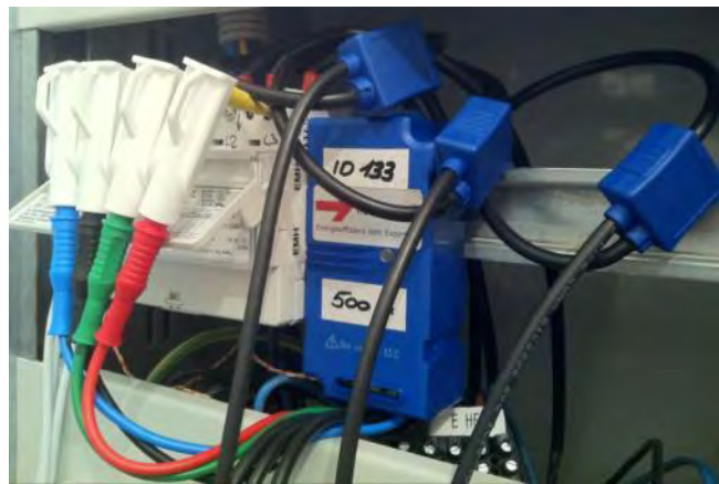
Abbildung 42: Drehstromzähler und Funkkonzentratoren
