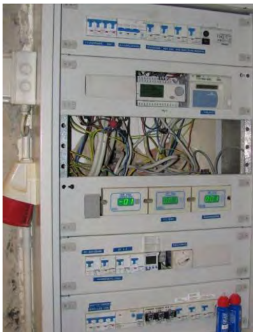
Abbildung 20: Steuerungstechnik für den Swimmingpool
